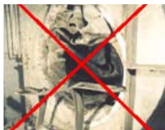
Evento catastrofico su un ventilatore
